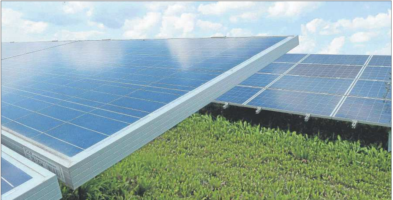
Gute Sonnenausbeute für die Wolfhager Stadtwerke: Vor allem in den Monaten April, Mai und August wurde viel Strom im Solarpark Gasterfeld erzeugt.
