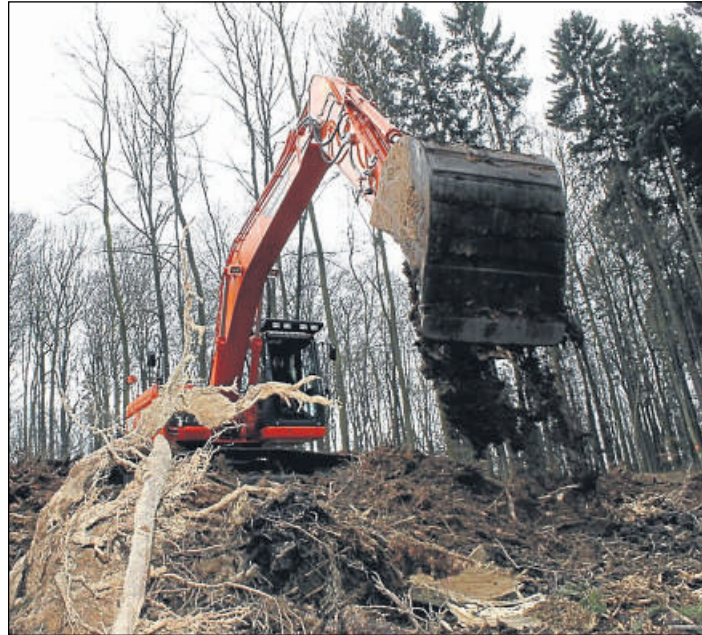
Im Einsatz: Ein Bagger bei Entwurzelungsarbeiten für den Wegebau des Windparks am Rödeser Berg.
