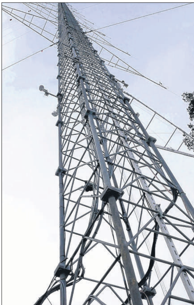
Auf dem Rödeser Berg: Eine Windmessanlage ist an einem Strommast angebracht.
