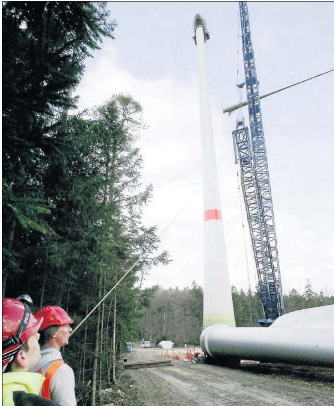
Sicherung am Seil: Anlagenmonteur Sascha Schröder (rechts) gibt gemeinsam mit einem Kollegen dem Rotorblatt am Haken des Krans Führungshilfe.
